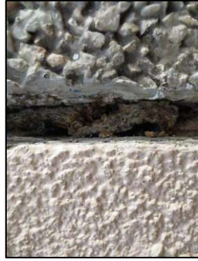
Photo N° 3186 ECH-N°11 -BAT 86-190 pignons Entre le mur du local et mur du bâtiment Joint fibreux
