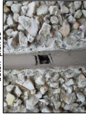
Photo N° 3179 ECH-N°07 -BAT 86-190 pignons Murs Joint de dilatation
