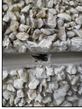
Photo N° 3173 ECH-N°03 -BAT 86-190 pignons Murs Joint de dilatation
