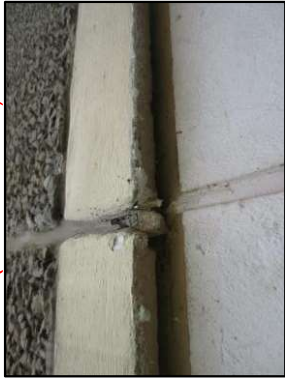
Photo N° 3239 ECH-N°50 - BAT113-157 pignons Murs Joint de dilatation
