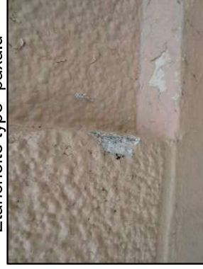
Photo N° 3182 ECH-N°09 -BAT 86-190 pignons Murs local béton+crepi+peinture
